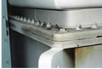
تسريبات الزيت Oil Leaks
